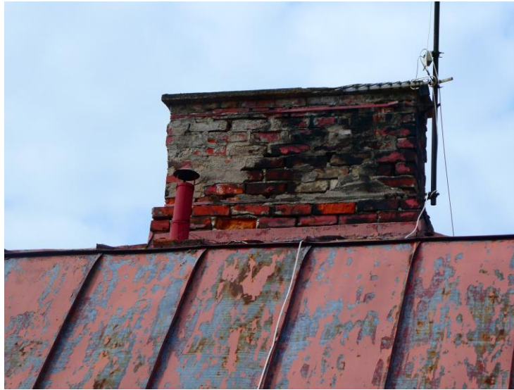
Kuva 12. Vesikatto vuotaa piipun läpimenon kohdalta. Vesikatteen maalipinta on kulunut ja ruosteessa. Savupiippu on rapautunut Vesikatolle ei ole turvallisia kulkutikkaita ja kattosilloja
