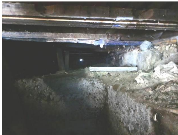
Kuva 2. Alapohjan puurakenteissa oli paikoin lahovaurioita Kulmakadulta valuvat vedet rasittavat rakenteita.
