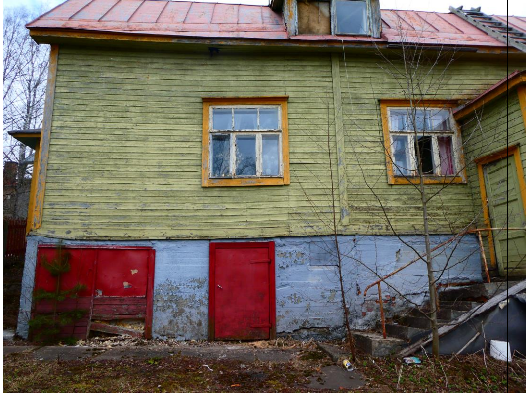
Kuva 8. Julkisivu länteen (Päämajakadun suuntaan) Sokkelissa on pullistuma ja talon ulkoseinä on notkahtanut. Vaurioiden korjaaminen on teknisesti vaativaa ja taloudellisesti arveluttavaa.
