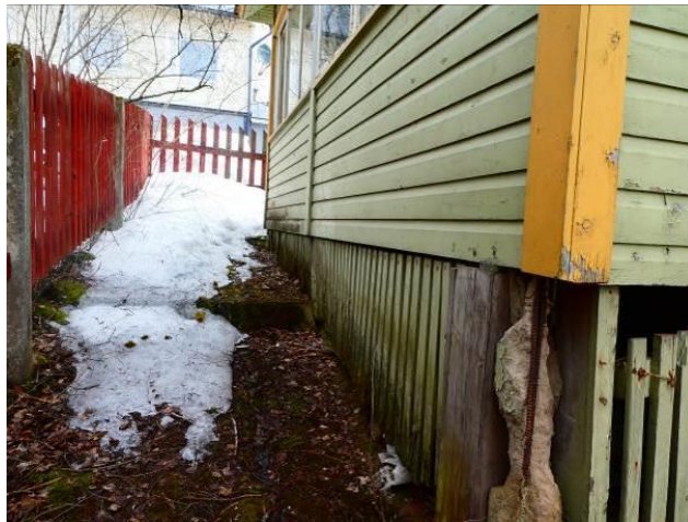
Kuva 4. Nurkassa oleva betonipilari on rapautunut. Puuverhoiluissa on lahovaurioita.
