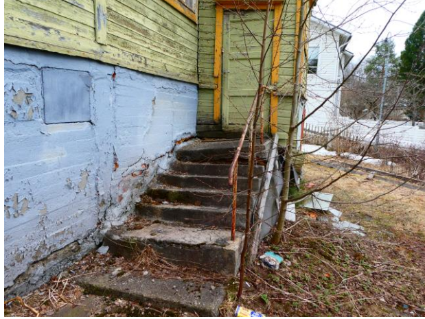
Kuva 3. Betonisokkelissa oli pullistuma ja halkeamia. Ulko-ovi on haristunut ja portaikko on huonokuntoinen.
