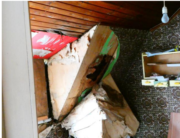
Kuva 21. Asunto 3 (yläkerta) huoneen kattoikkunan kohdalla rakenteissa kosteusvaurioita
