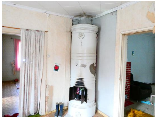
Kuva 18. Asunto 1 pönttöuunin piipun kohdalla oli vuotovauroita.
